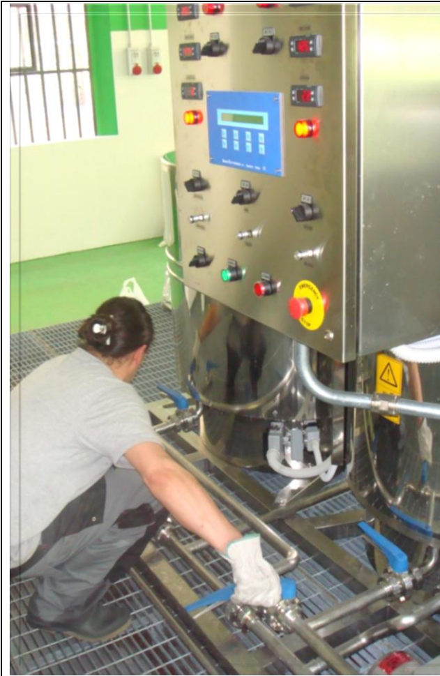
PARTICOLARE: QUADRO PLC
